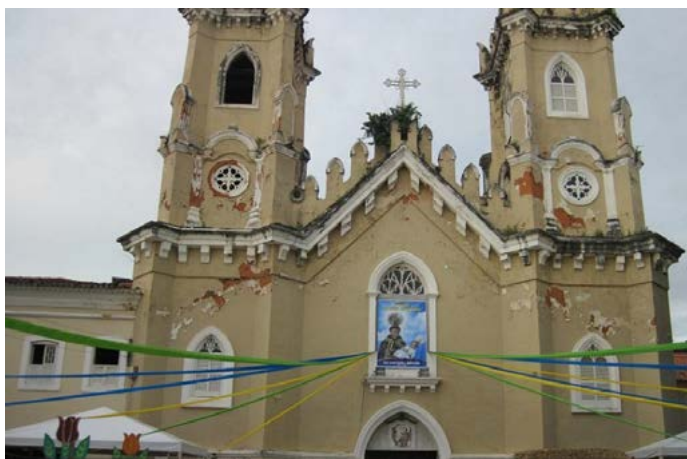
ANEXO A – Fotografia da fachada da Igreja de Santo Antônio em São Luis - MA
